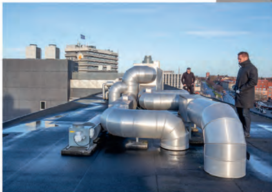
Kontorsbyggnaden har sina nya kylaggregat med propan som köldmedium installerade på taket.
