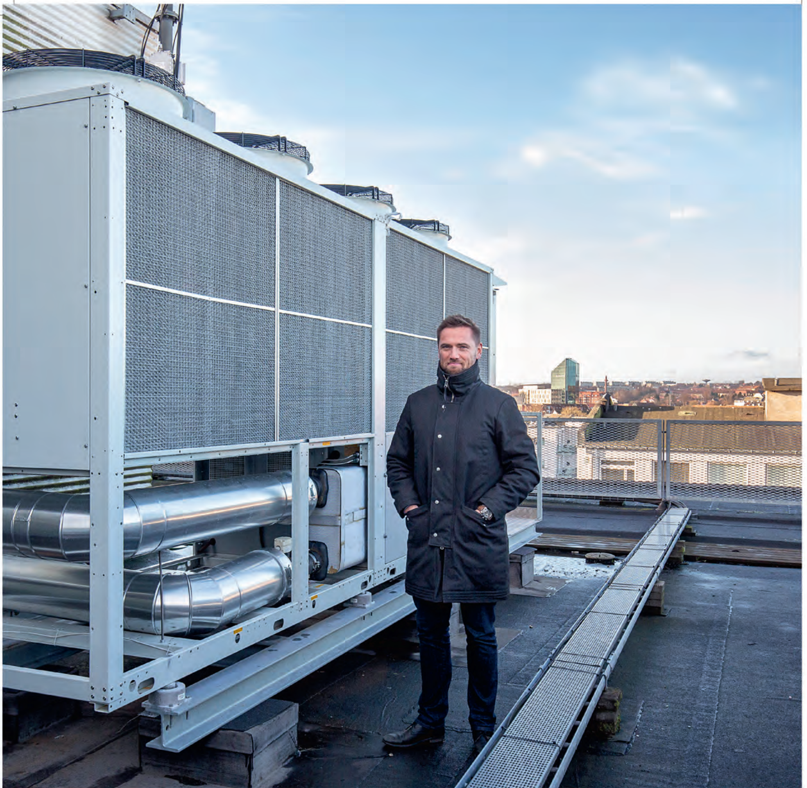
Stefan Haugaard vid den nya kylmaskinen som är placerad på varuhusets tak.
