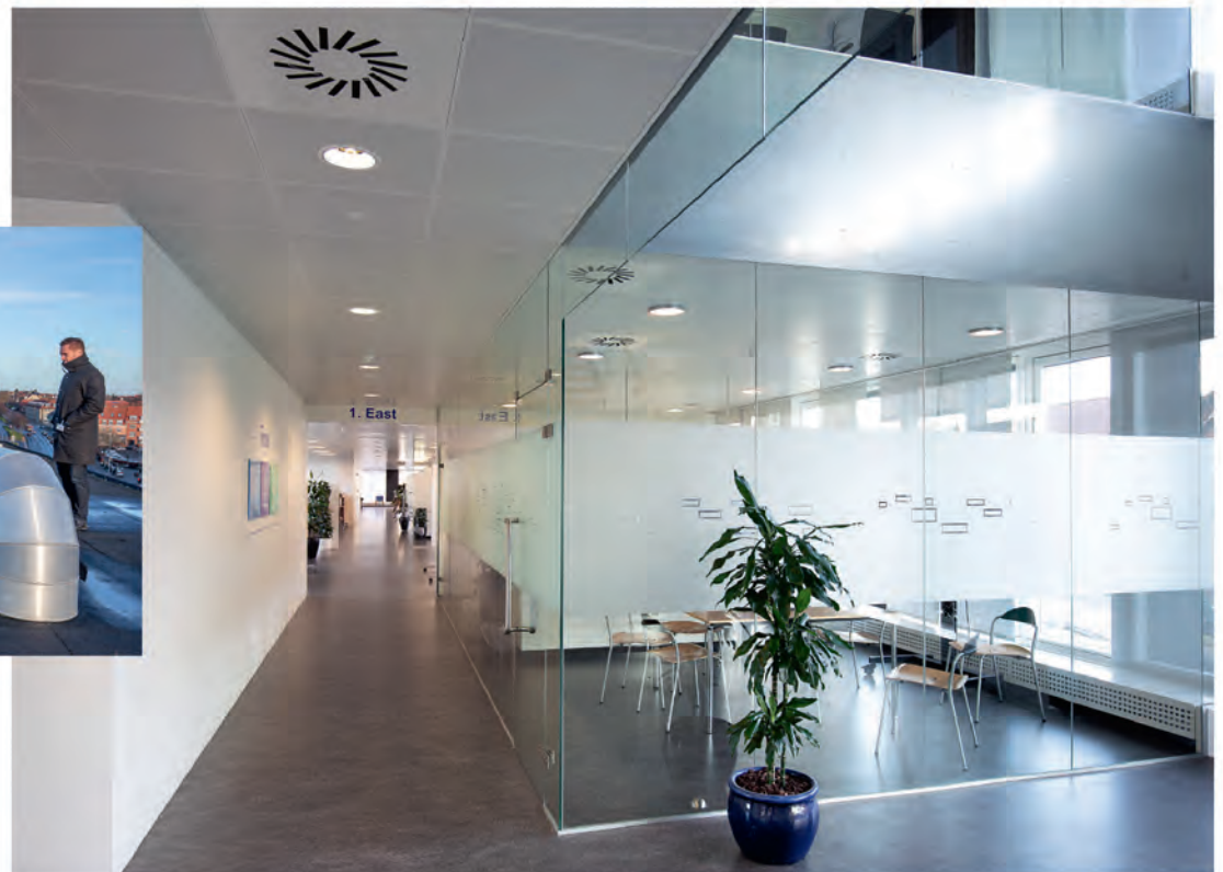
Kontorshuset har tre olika ventilationssystem för komfortkylan.
